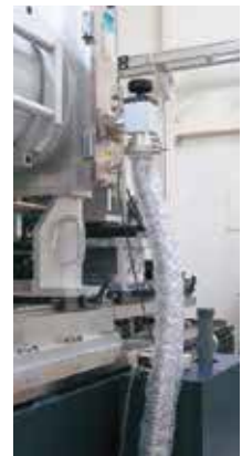
新真空パス配管
