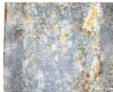
メッキの腐食
