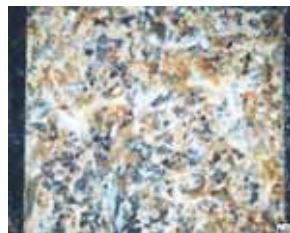
メッキの腐食
